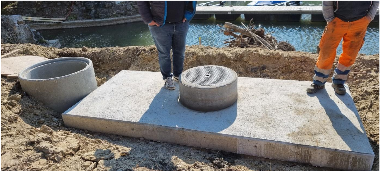
Foto 11: Neuer Biberbau mit Decke inkl. Einstiegsschacht und Elektroschacht für Kameraeinrichtung.
